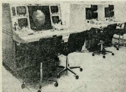
Рис. 2. Автоматизированные рабочие места операторов
